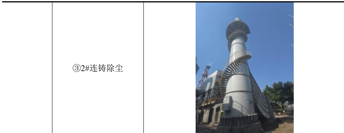
图 4-1 废气治理措施落实情况
